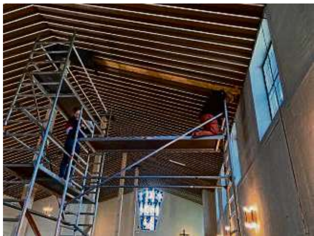
Um die Statik der evangelisch-reformierten Buchenbuschkirche zu sichern, wurden zahlreiche Notstützen eingebaut.
