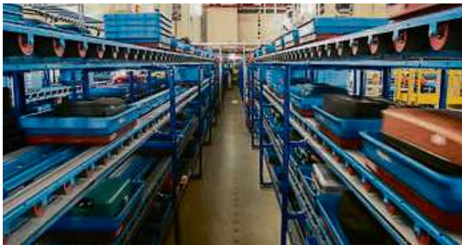
In der Gepäckförderanlage, die seit 50 Jahren in Betrieb ist, dösen die Koffer so lange im Kreis, bis sie im Flugzeug verladen werden. Foto: Fraport/p
