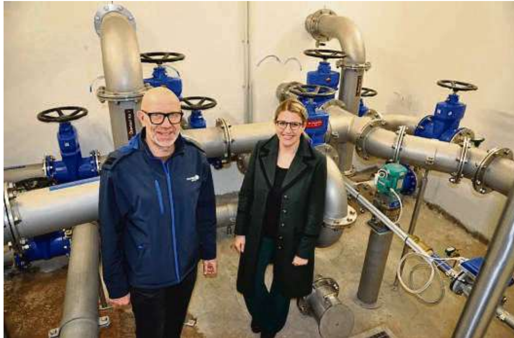
Julia Antoni und Dieter Gredig im sanierten Hochbehälter 3, der bereits 1911 gebaut wurde.
