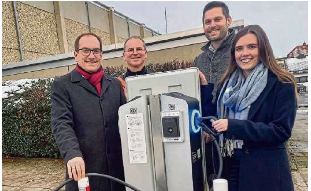
Nahmen die Ladesäule auf dem Parkplatz an der Hasselgrundhalle in Betrieb: Bürgermeister Dr. Frank Blasch, der städtische Klimabeauftragte Detlef Schümann, Björn Temp und Denise Temp vom Unternehmen On-Charge (v.l.)
