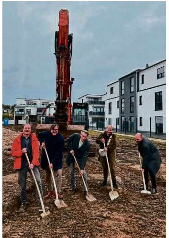
Spatenstich auf dem Gelände der ehemaligen Schreinerei Ebert: An der Robert-Koch-Straße 8 entstehen bis Ende 2025 34 Eigentumswohnungen, einige davon sind für betreutes Wohnen vorgesehen.
