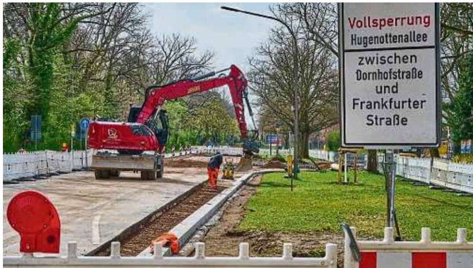
Die südliche Frankfurter Straße ist noch bis Ende April eine Großbaustelle: Zu sehen ist die Einmündung der Hugenottenallee (von rechts) in die Frankfurter Straße. Diese ist derzeit stadtauswärts nach Dreieich eine Einbahnstraße.
