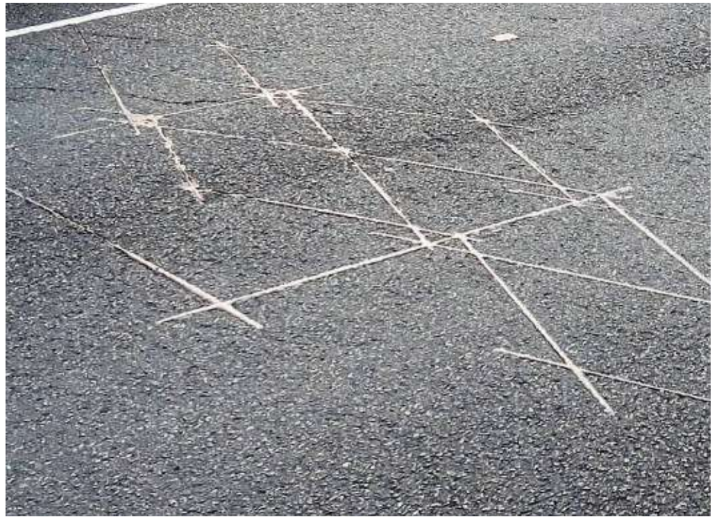
So sehen die Induktionsschleifen aus, hier in der Rostädter Straße.
