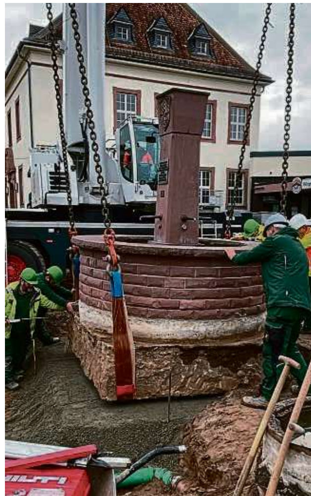
Stadtumbau Dudenhofen: Ein Kran hat den schweren Brunnen auf einen neuen Sockel gesetzt. Das war Maßarbeit. FOTO: STADT
