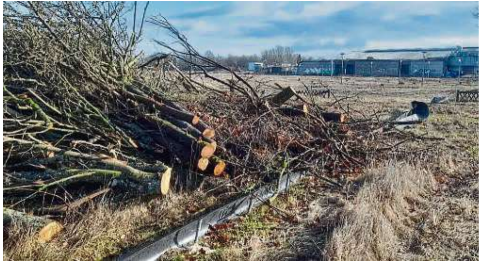
Die Rodungsarbeiten an der Kapellenstraße sind abgeschlossen. Das macht den Weg frei für die weitere Erschließung des acht Hektar großen Gewerbegebiets, in dem ein großes Rödermärker Unternehmen neu bauen möchte.
