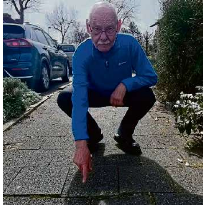
Stolpergefahr direkt vor der Haustür: Anwohner Wolfgang Petersen zeigt die herausstehenden Platten. Mehrfach seien Dietzenbacher bereits darüber gefallen. FOTO: BÄR
