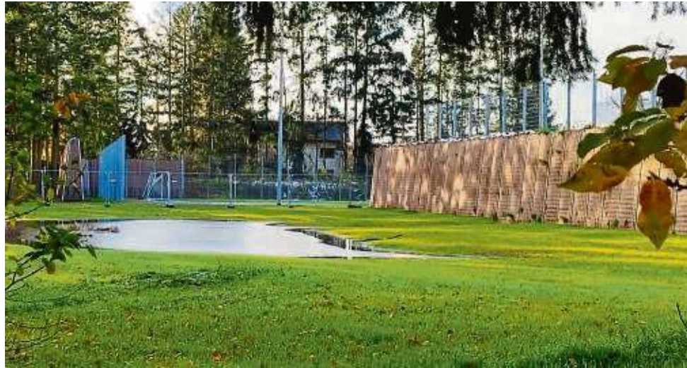
Planungsfehler? Nicht nur am Kleinspielfeld, auch zwischen den Hauptspielfeldern klaffen in Richtung Wohnbebauung im Lärmschutzwand des Sportzentrums Dicke Buche in Dörnigheim mehrere Meter breite Lücken.
