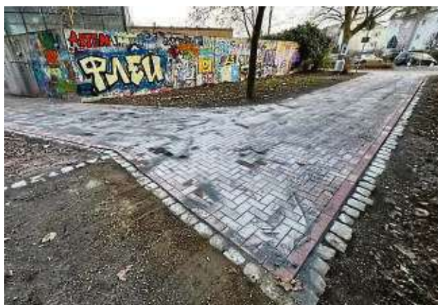
Der Zuweg über den Erlenpark wurde instand gesetzt und Pflasterflächen angelegt, sodass die Bürgerinnen und Bürger trockenen Fußes zum Servicebüro gelangen.
