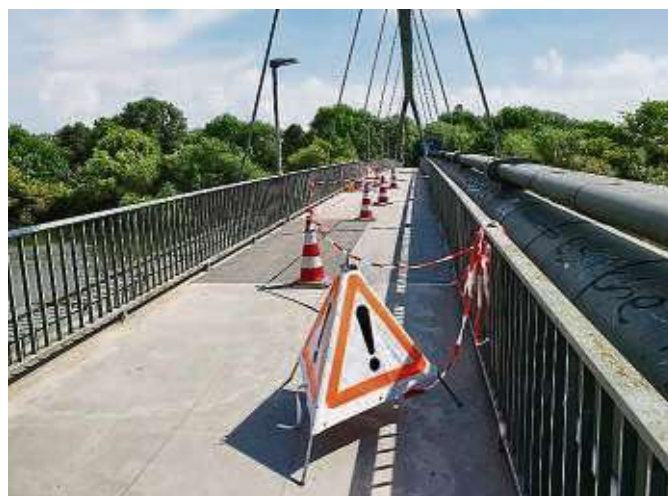
Bis die Instandsetzung des Arthur-von-Weinberg-Stegs losgeht, können kleine Reparaturen des Gehwegbelags nötig werden. Archivfoto: sh
