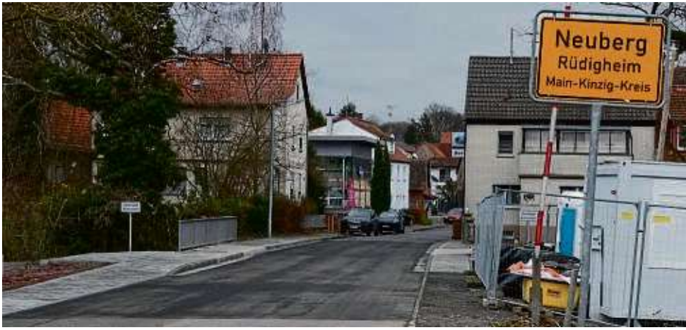
Der Brückenneubau über den Krebsbach am Ortseingang von Neuberg-Rüdigheim wurde abgenommen und für den Verkehr freigegeben. FOTO: CLAUS DIEGEL
